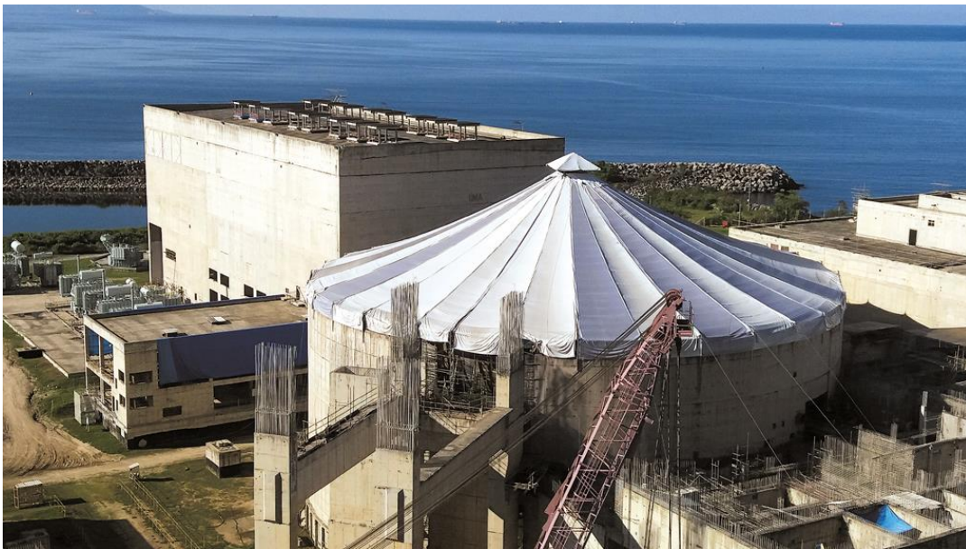
Obra parada: Cobertura instalada para proteção de equipamentos na usina de Angra 3
