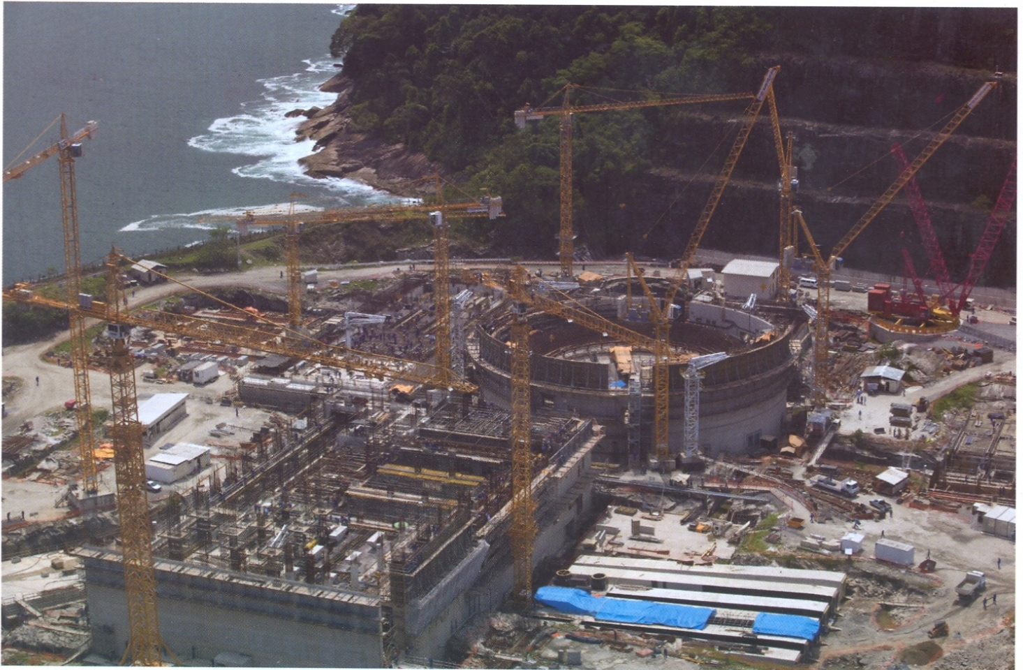
Vista geral da Central Nuclear Almirante Álvaro Alberto, em Angra dos Reis (RJ)
